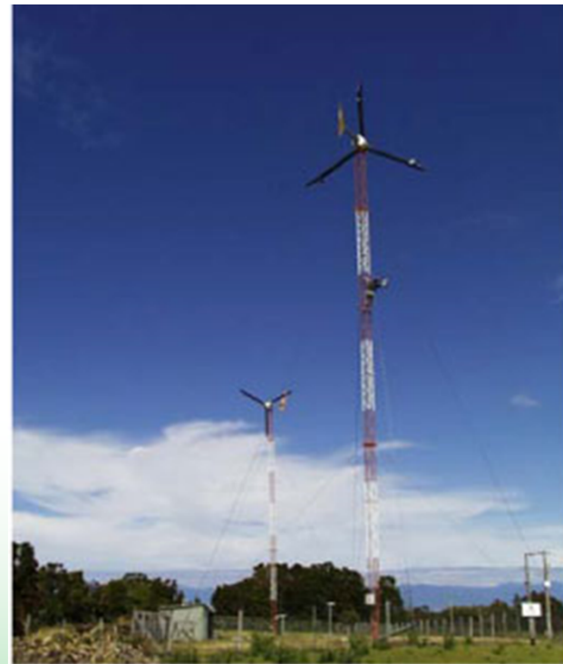
Sistema eólico-diésel, Isla Tac - Chile
