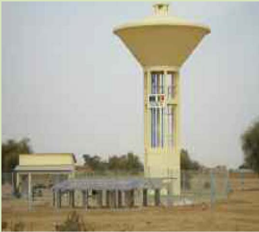
Système de pompage photovoltaïque
